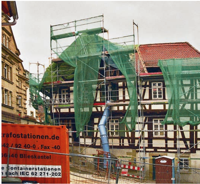
Abb. 1: Das Haus Pforzheimer Str. 7 (Hebererhaus) nach dem Brand vom September 2007 (Foto: Christopher Retsch, 2008)
