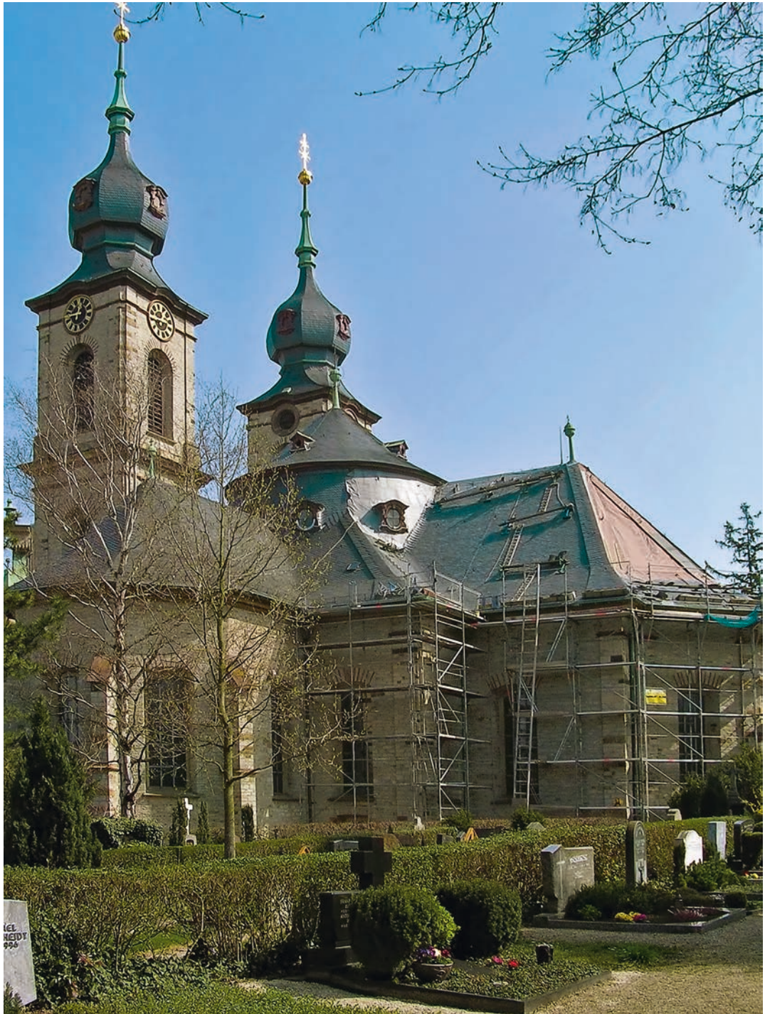
Die aufwändige und kostenintensive Dacherneuerung dient dem Sakralbau als unverzichtbarer Witterungsschutz vor Stürmen und Regen (Foto: Stefan Schuhmacher)
