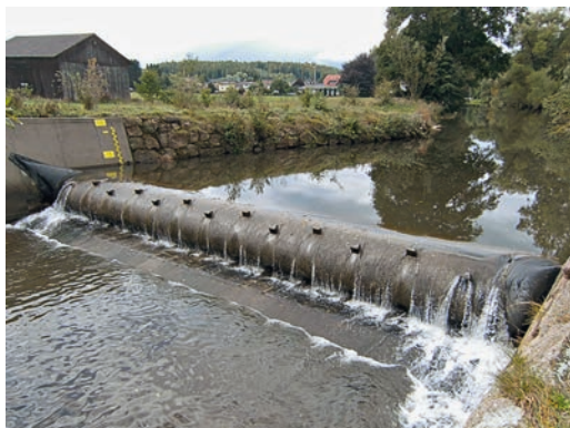
Schlauchwehr am Ortsausgang von Wolterdingen
