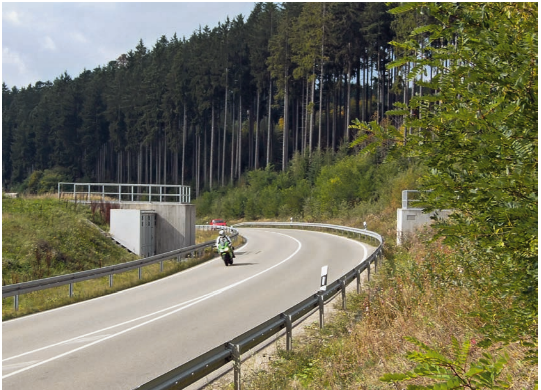
Dammbalkenverschluss an der Landesstraße L 180
