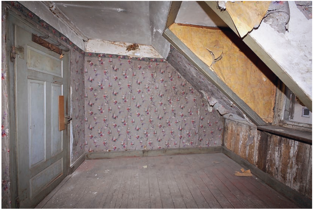
Wie hier beim Altstadt haus in Konstanz war auch bei den anderen Objekten die Bausubstanz vor Beginn der Sanierung durch Leerstand und fehlende Bauunterhaltung in einem äußerst desolaten Zustand. © Preisträger
