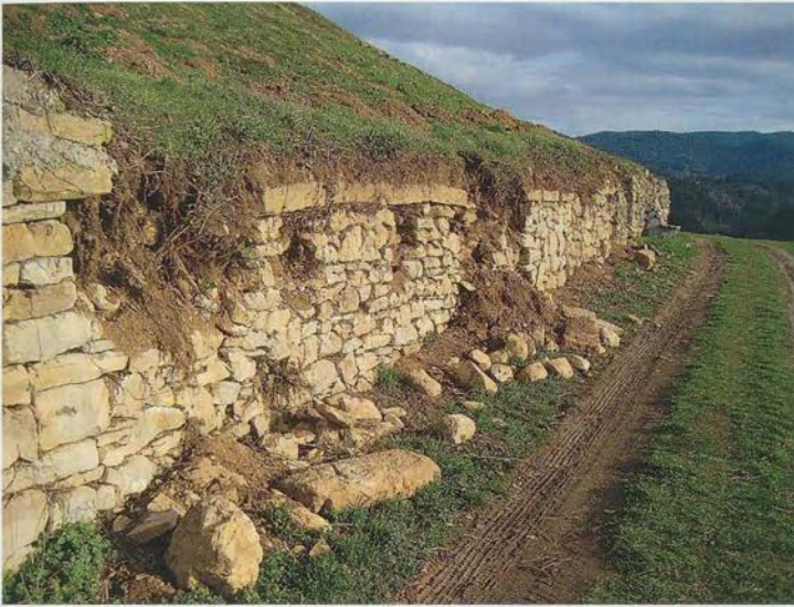
Schadstellen an Trockenmauer.
