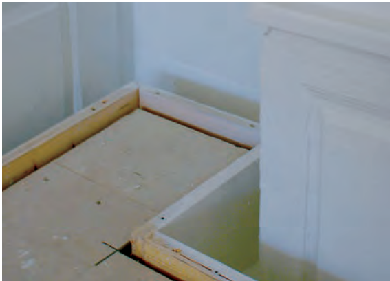
Abb. 14: Abstand vom neuen Fußboden zur alten Wandvertäferung.
