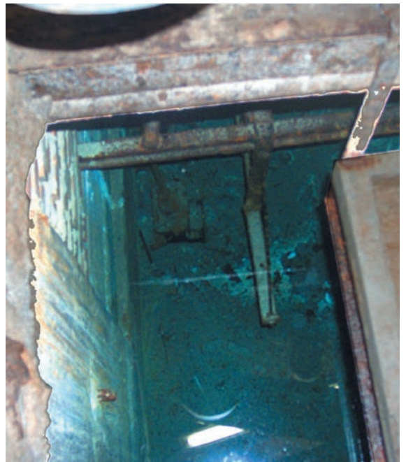
Quellschacht mit Blick auf den, links sichtbaren, Quelleinlauf.
