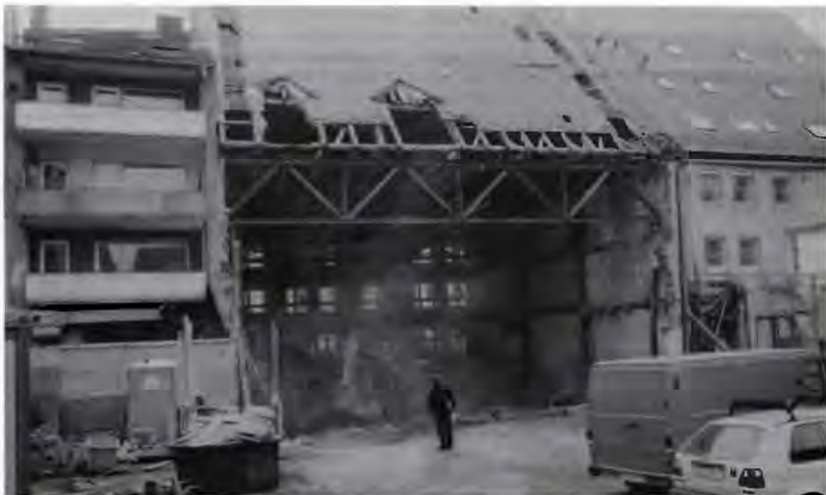
Im Frühjahr 1989 begann für das große alte Haus an der Rietstraße ein neuer geschichtlicher Abschnitt. Von der Webergasse geht der Blick auf die Rückseite des einstigen St. Katharinentaler Verwaltungssitzes, wo gerade die Baumaschinen dabei sind, das Gebäude völlig auszukernern.
