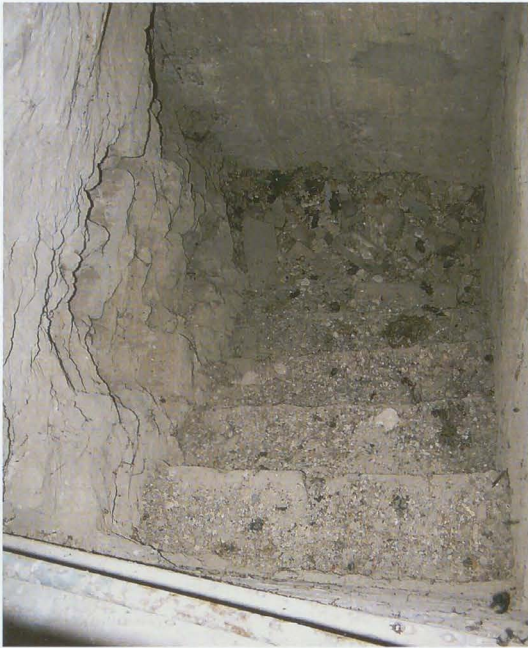
Abb. 17: Nachträglich eingebrochene Treppe vom 1. OG des Turmes hin zum OG des Seitenschiffes
