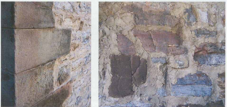
Abb. 25: Brandspuren am Mauerwerk des Palas; links Gewände der Tür zwischen Palas-Obergeschoss und Kapellen-Empore, rechts Palas-Erdgeschoss: typische Rotfärbung und Abplatzung am Gestein nach starker Feuereinwirkung.
