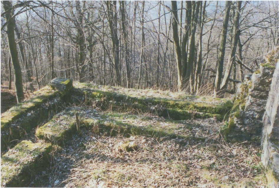
Abb. 8: Kanal eines verwitterten Ringankers am Bergfriedrest der „Hinterburg“ Eberbach.
