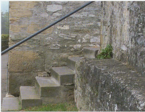
Abb. 16: Die Flucht der von Westen kommenden Ringmauer (rechts) stößt nicht auf die Nordwestecke des Steinhauses (links).
