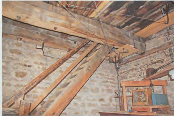
Die Wände, innen nur aus Kalksteinen. Aufgenommen in der Uhrwerksebene. Die Stahlseile für die Hammerschläge sind zu erkennen.
