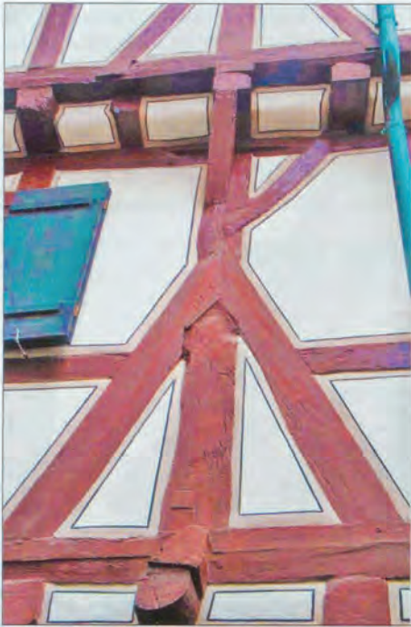
„Schwäbisches Weible“ im 1. OG der Südseite. Die Fußstreben sind in die Schwelle gezapft und im Ständer verblattet. Die linke Kopfstrebe fehlt.
