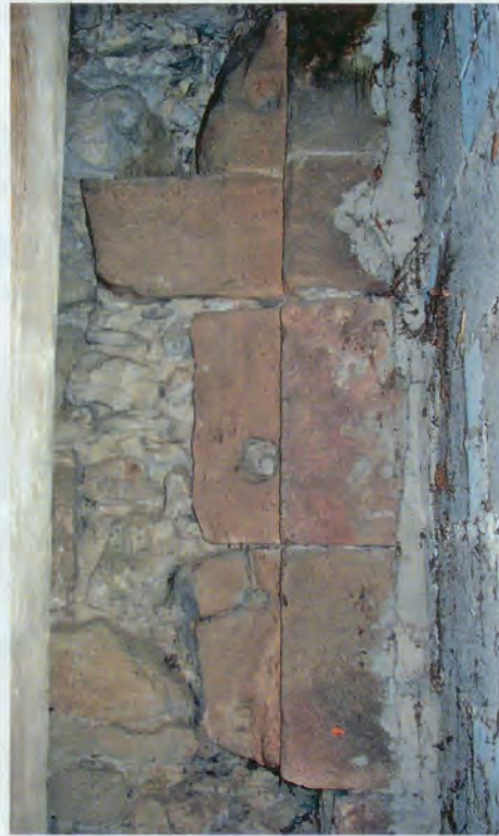
Burg Altwiesloch – Reste einer Tür (vielleicht ehemaliger Kapelleneingang).
