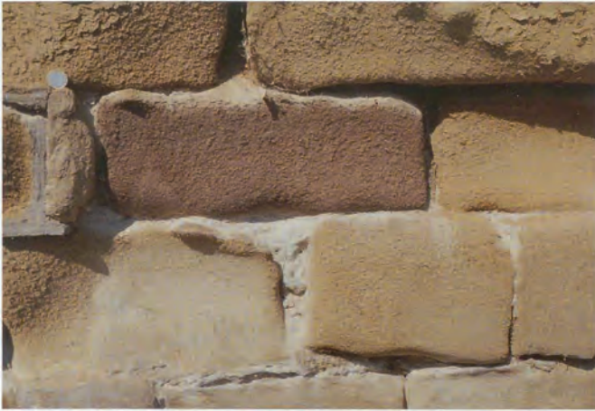
Abb. 12: Verwitterungsschäden in der Schlossparkmauer von Eichtersheim in Form von Abschuppen (links oben) und Absanden (Mitte rechts).
