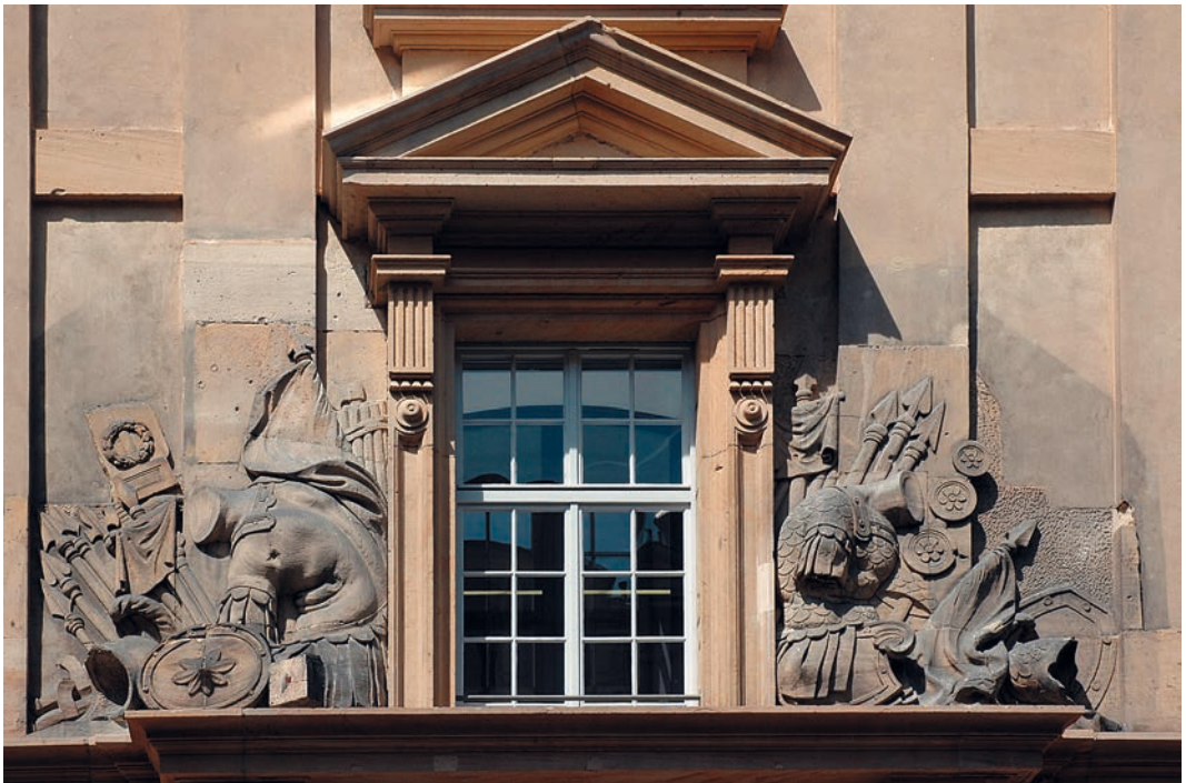
Detail Zeughaus Fenster der Seitenfassade, (rem. Jean Christen)
