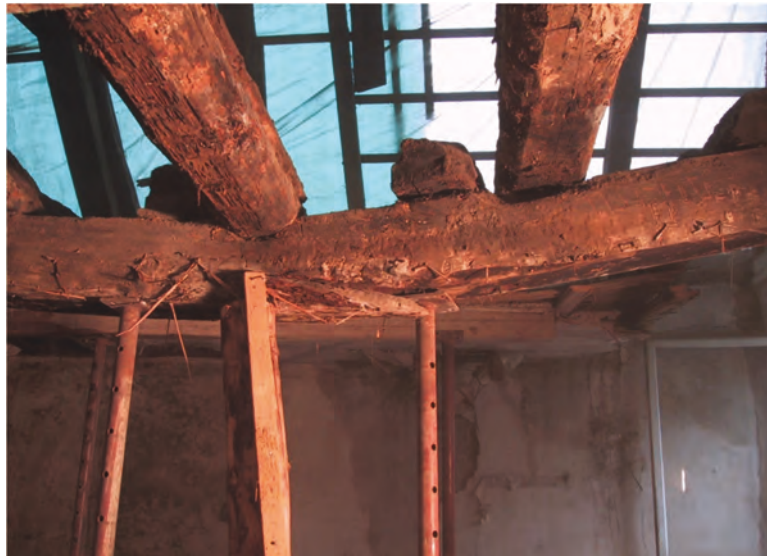
Gebrochener Balken in der Erdgeschossdecke
