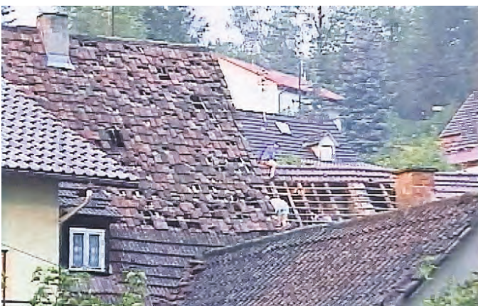
Bilder vom Hagelschaden 1996 in Untergimpeln
