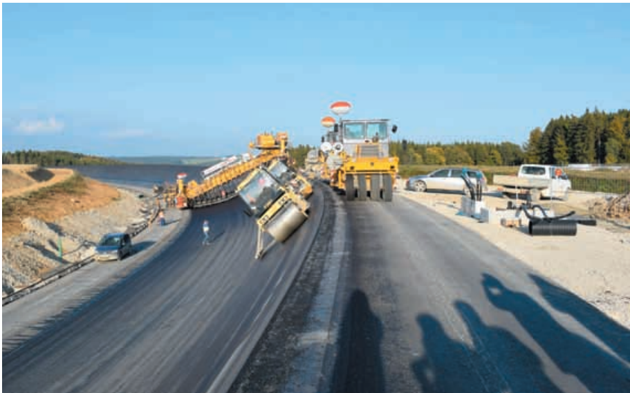
Der sogenannte Brückenfertiger ermöglicht den Bau der zwei überhöhten Kurven des Ovals.
