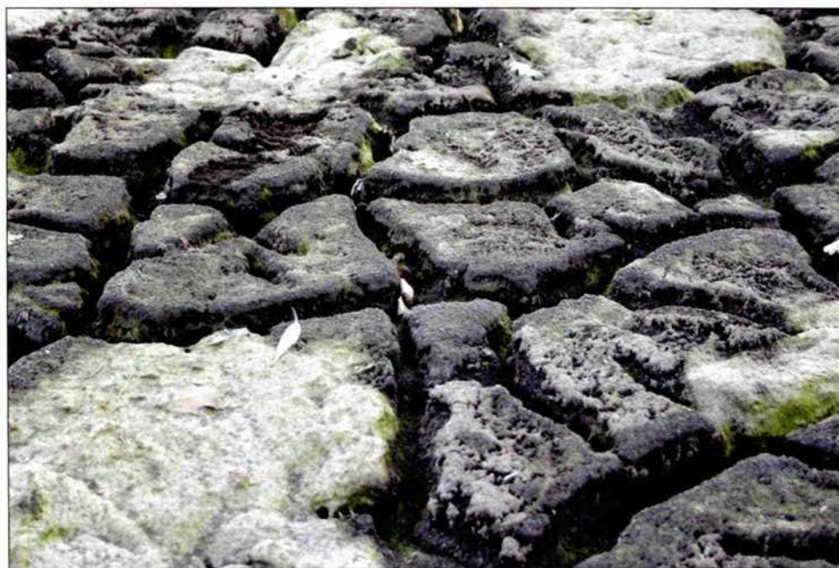
Abb. 2: Der abgetrocknete Teichboden des Unterhölzer Weihers im Frühjahr 2005. Deutlich sind die tiefen Trockenrisse in der Faulschlammschicht zu erkennen.
