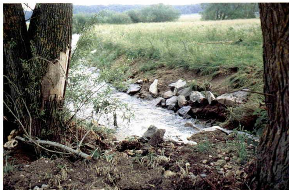
Abb. 17: Unsinnige Flussbaumaßnahme im „Integrierten Donauprogramm“: Das erste Hochwasser vom 1.6.2000 unterspülte die neue richtlinienwidrige Uferpanzerung eines vorher durch natürlichen Bewuchs völlig geschützten Grabenufers bei Neudingen
