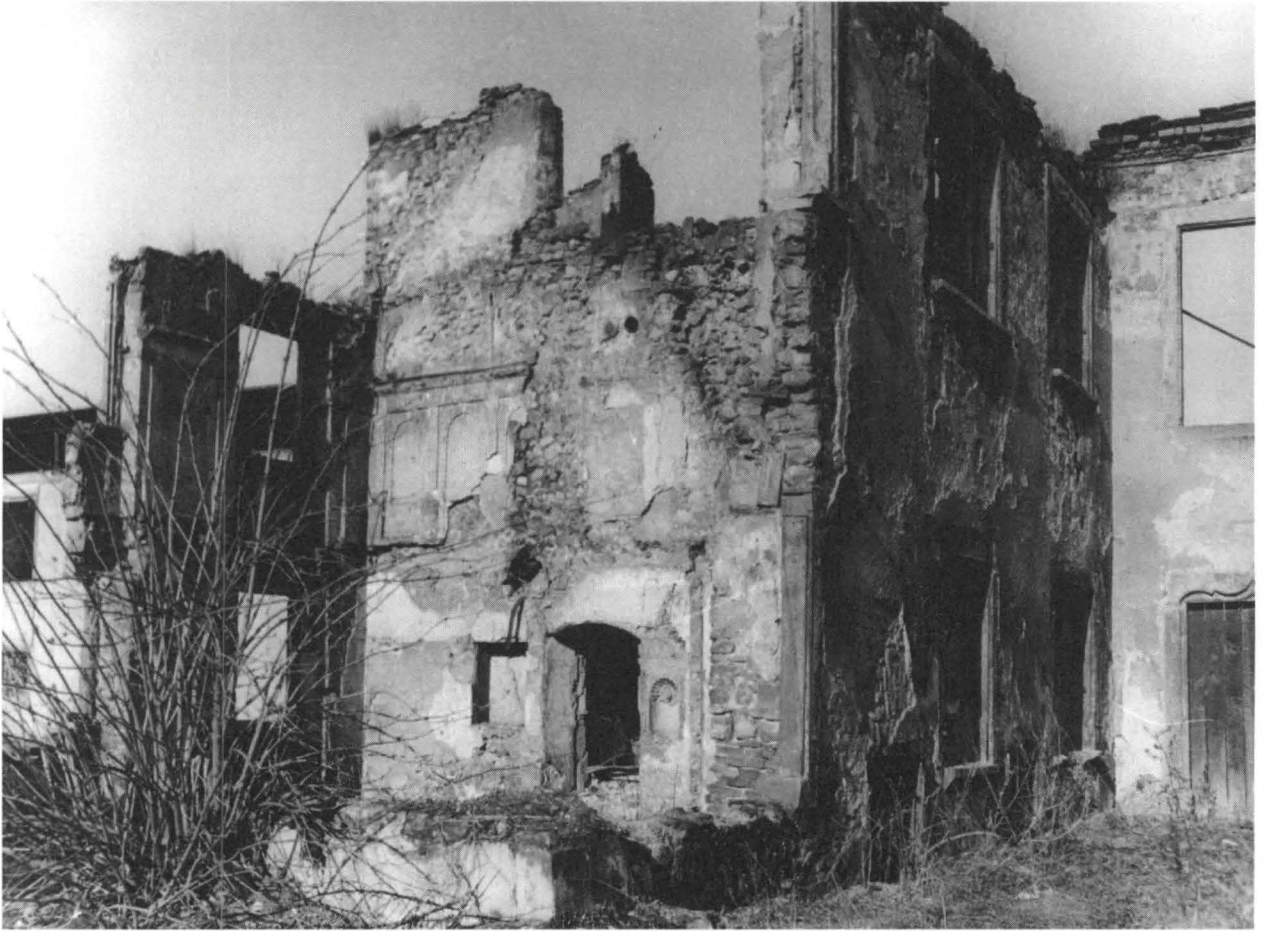
Abb. 4 Nordostbau nach der Kriegszerstörung 1944, von der Niemensstraße aus gesehen. Im Erdgeschoss ehemals der Speisesaal mit Tür und seitlicher Handwaschnische, darüber der Festsaal mit aufstuckierter Wandverkleidung. Das senkrechte Mauerstück darüber ist Teil des hofseitigen Treppenturms (UBA, Akten FR 0-555, Peterhof – Bauwerksnummer 03105550, PET 210)
