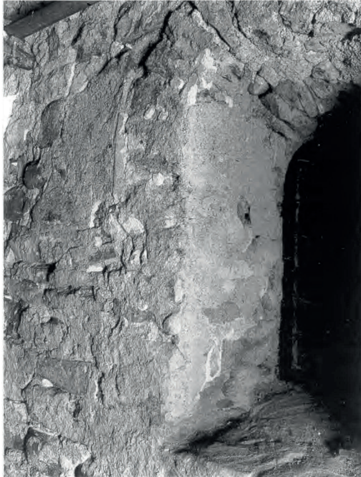
Abb. 6 Westfenster der Langhaus südwestwand mit Resten der Originalfasche. (Photo J. Jeras, Gündlingen)
