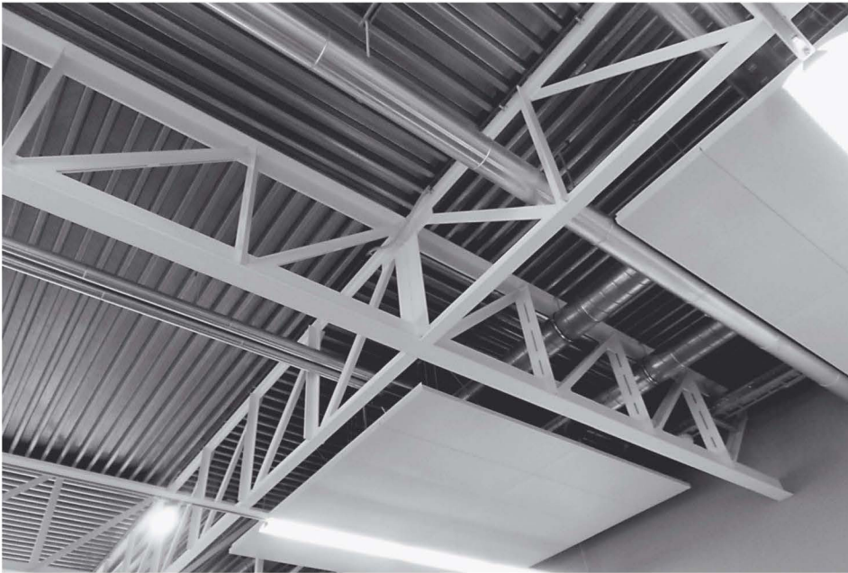
USM-Betriebsanlage Bühl: Beim Stahlbau- system Maxi bilden 1,20 Meter hohe Gitterträger aus verschweißten Stahl- profilen die Dachkonstruktion. (Foto: Coenen)
