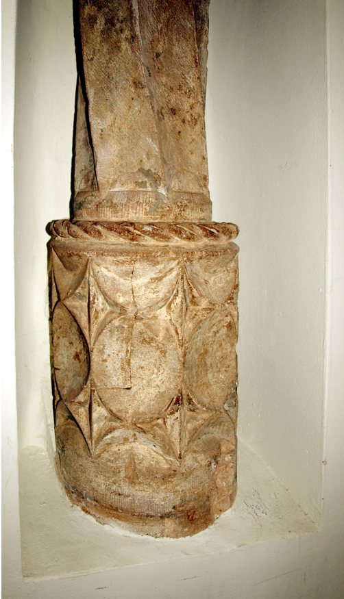
Abb. 10: Freigelegter spätgotischer Pfeiler zwischen den ehemaligen Fensternischen im westlichen Saal, Obergeschoss des „Hinteren Kaufhauses“. Foto: Frank Löbbbecke, 2010.
