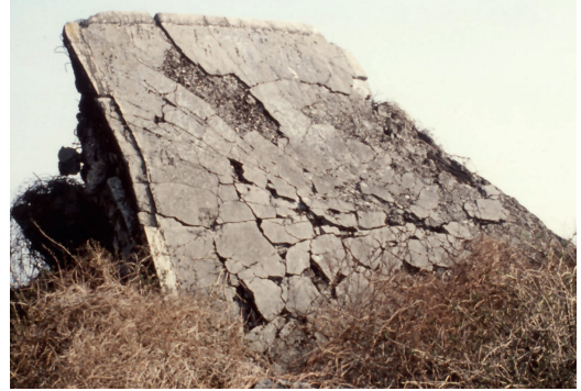
Abb. 11: An dieser gesprengten Bunkerdecke ist aufgrund des Verlaufs der Risse die Lage der Sprengladung gut erkennbar. Foto: Friedrich Wein.
