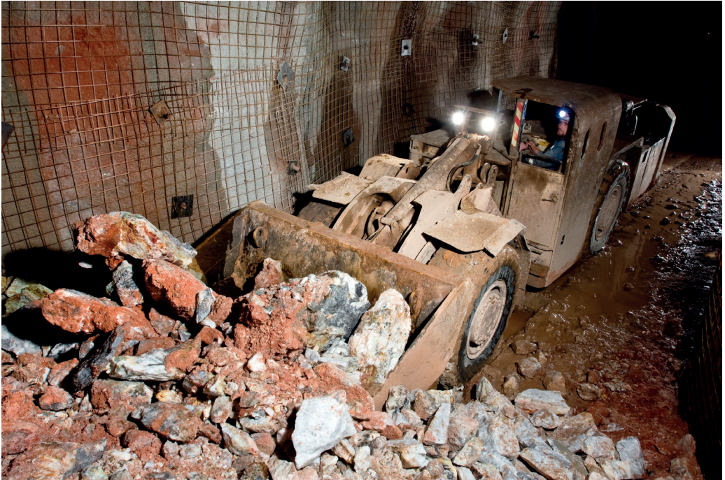
Abb. 54: Lader im Streckenvortrieb auf der Fluss- und Schwerspatgrube Clara bei Oberwolfach, Mittlerer Schwarzwald. Foto: Sachtleben Bergbau GmbH.
