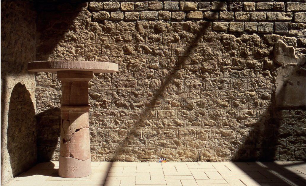
Abb. 45: Mauer aus Haupttrogenstein-Quadern mit typisch römischem Fugenstrich im Keller der Villa Urbana von Heitersheim. Im Mörtel dieses Landguts konnten Pochsande von römischen Bergwerken (Sulzburg? Badenweiler?) nachgewiesen werden. Foto: Wolfgang Werner, LGRB.
