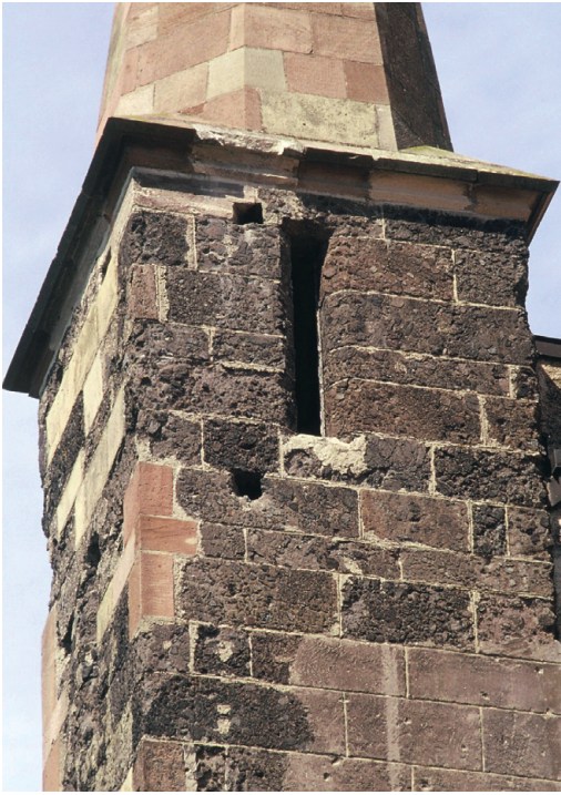
Abb. 6: Treppenturm des Breisacher Münsters mit mehr oder stark angewitterten Quadern aus Tephrit-Pyroklastit des „roten“ Typs. Foto: W. W.
