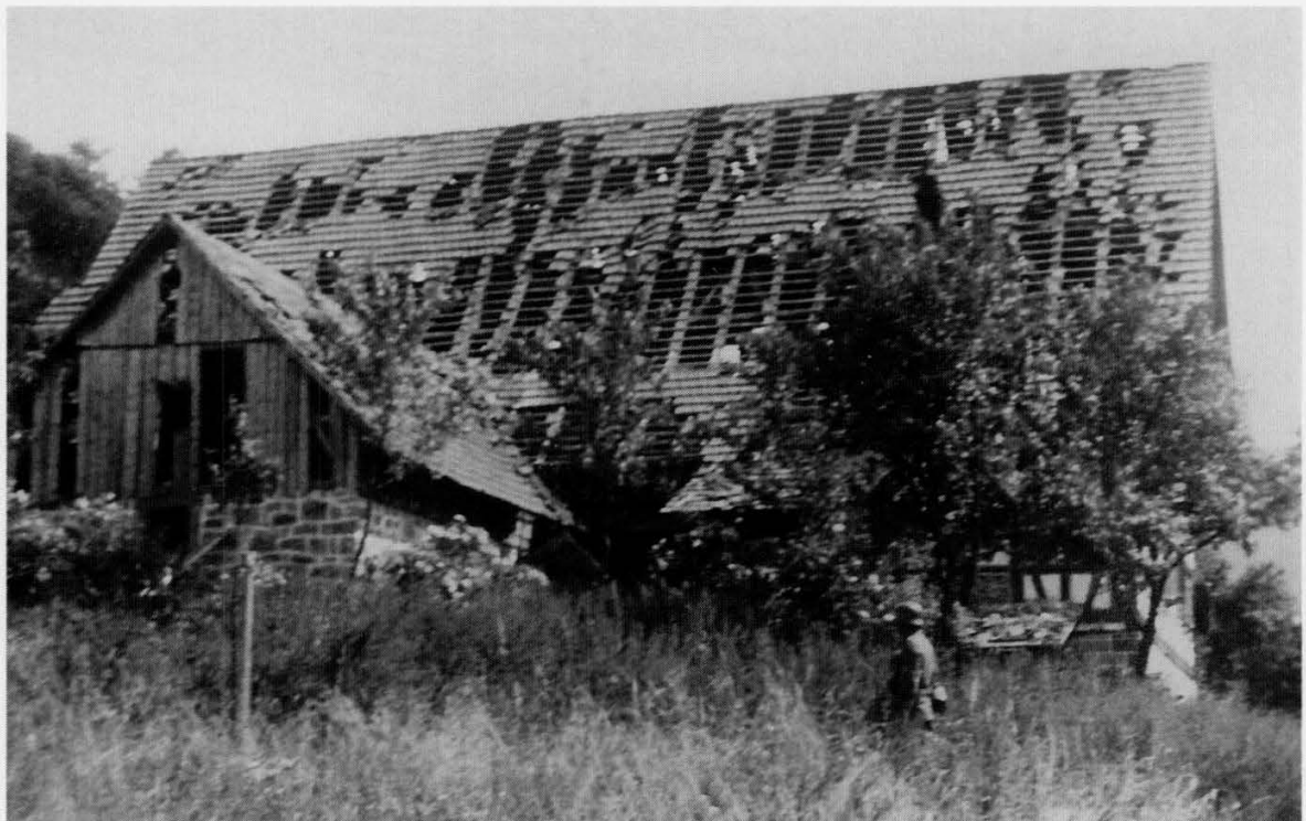
Durch die Druckwelle wurde der Bauernhof „Murhof“, der in unmittelbarer Nähe stand, schwer beschädigt. Das Dach wurde dabei weitgehend abgedeckt, Wände waren eingedrückt, Holzverschalungen abgerissen Abb.: Käshammer
