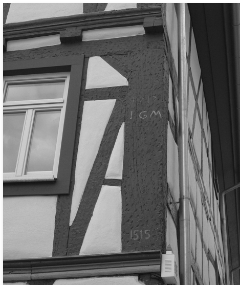
Inschrift im Eckpfosten des oberen (älteren) Gebäudes des Doppelhauses (Foto: Manfred Hellemann)
