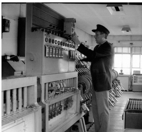
Das Blockwerk mit den Fahrstraßenhebeln. Der Wärter drückt die Blocktaste und erzeugt mit der Kurbel einen Wechselstrom für das elektronische Verschlusswerk.
