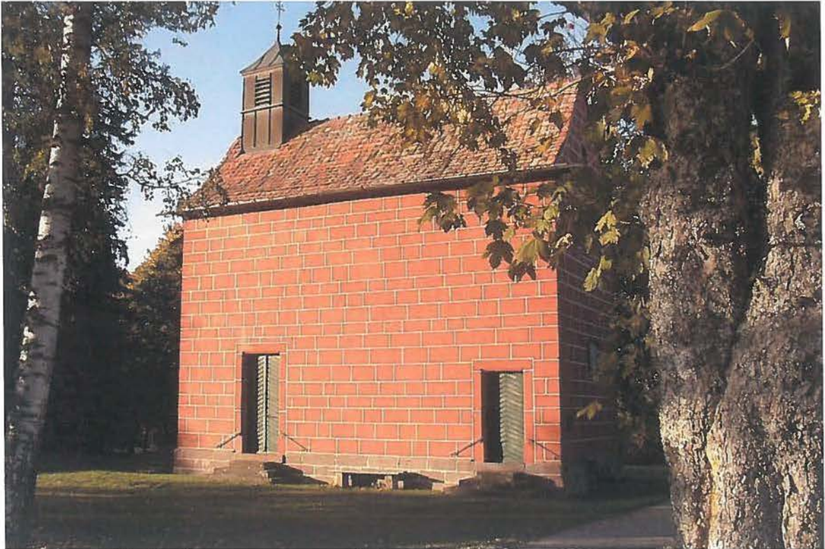
Die Loretokapelle auf der Hammerhalde, die aus Dankbarkeit für die Errettung aus der Tallard'schen Belagerung 1704, also vor 300 Jahren, gebaut wurde, muss dringend saniert werden. Der Geschichts- und Heimatverein wird dieses Vorhaben unterstützen.
