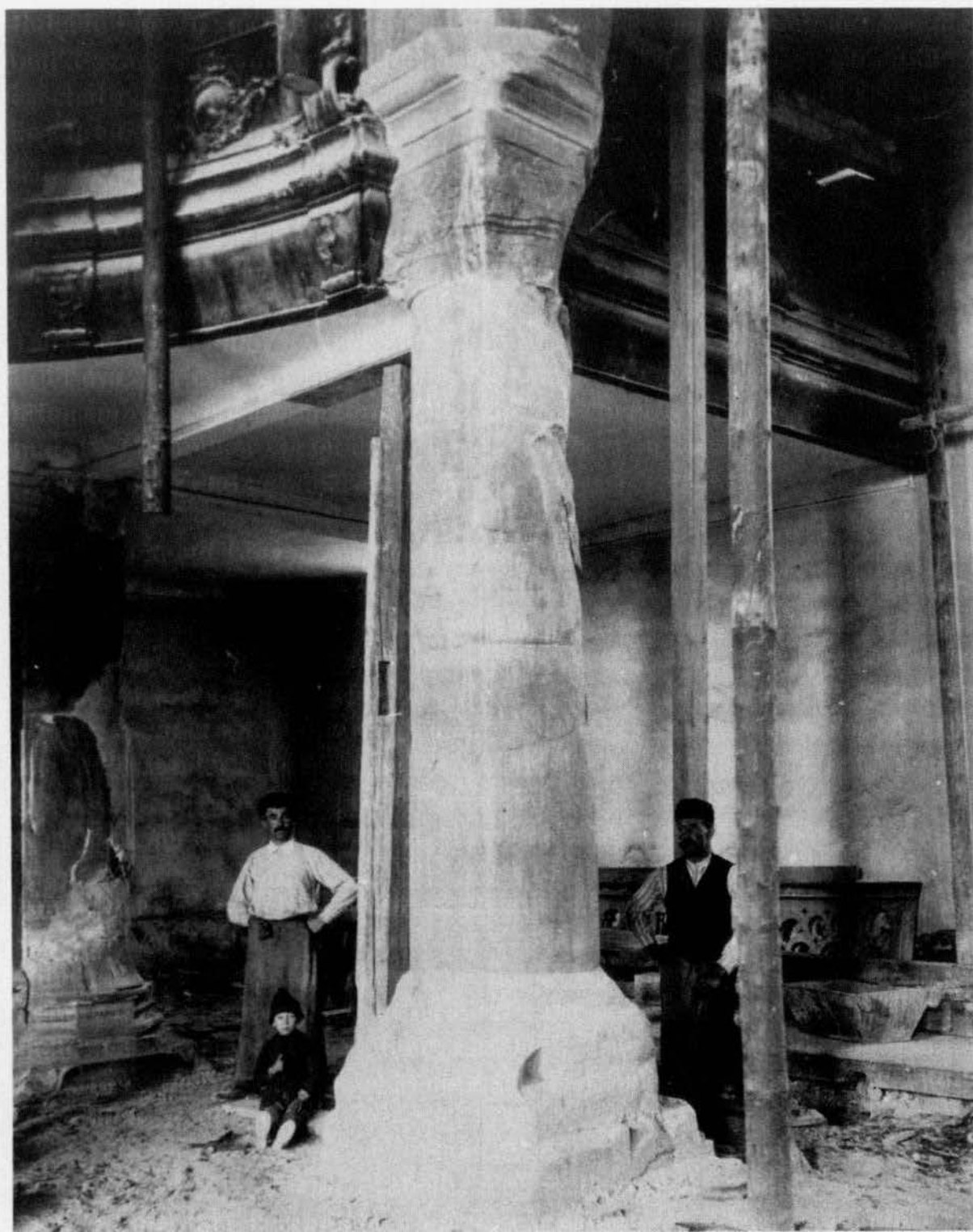
Abb. 10: Bauschäden an den Säulen am Westende der nördlichen Arkadenreihe; während der Restaurierungsarbeiten. Fotografie von Johannes Lohmüller, 1893. (HBA, Fotosammlung). Basis barock abgearbeitet, Kapitell durch barocke Orgelempore angeschnitten und teilweise verdeckt; im Hintergrund abgestellte einige abgenommene Holzbrüstungen der Seitenschiffemporen.
