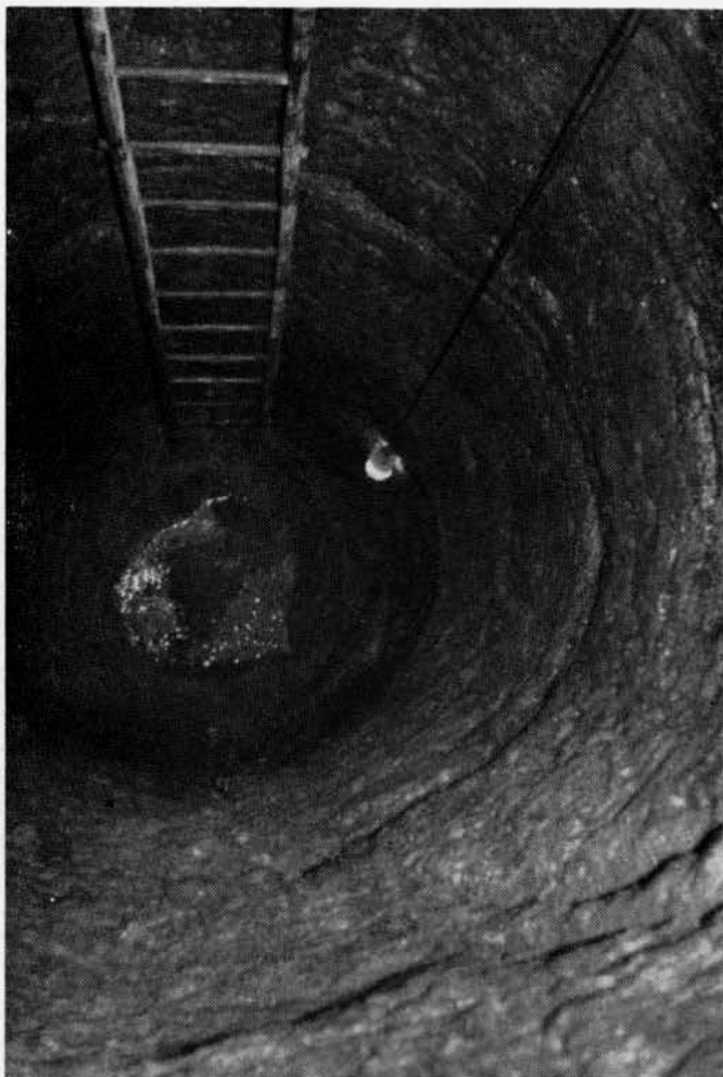
Bild 5 Ein Blick von oben in den Brunnen. Das eingedrungene Wasser ist auf der Brunnen- sohle hier deutlich erkennbar an den Licht- reflexen.
