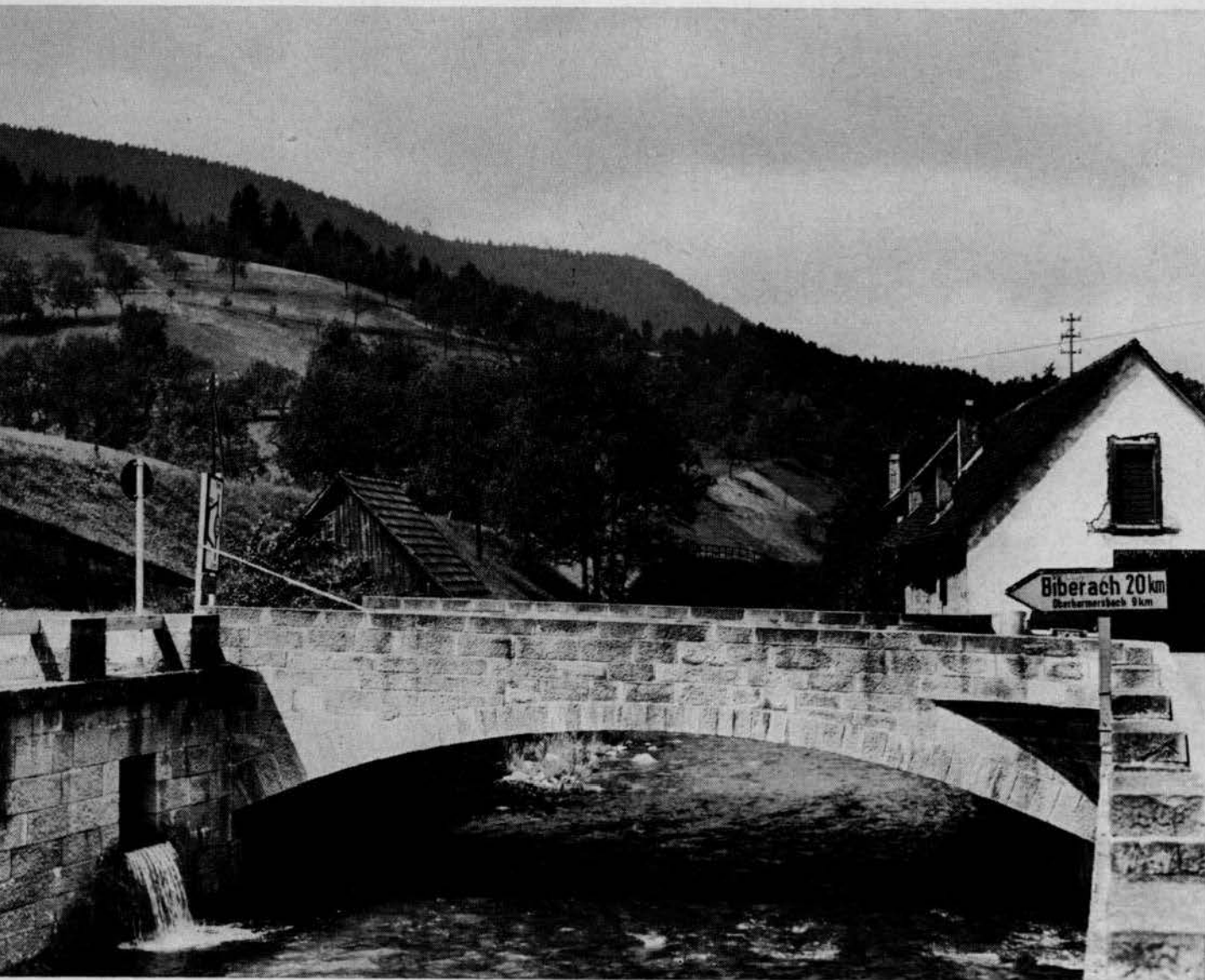
Brücke über die Rench in Löcherberg (beim „Pflug“), gemauert. Auffahrt zur Paßhöhe nach Oberharmersbach mit schönen Aussichten.
