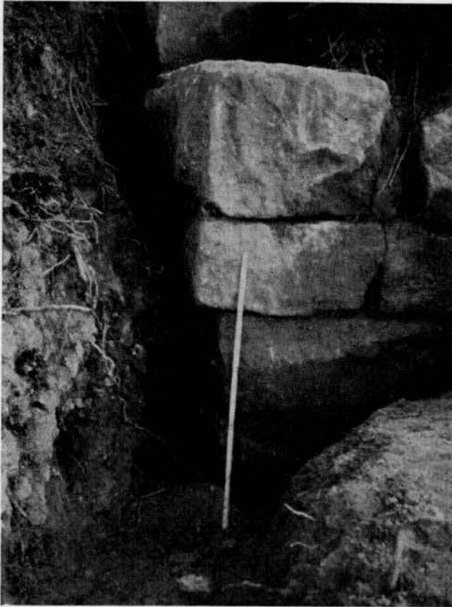
Abb. 5. Östliche Mauerecke der Willenburg; bearbeitete Sandsteinblöcke, ohne Bindemittel aufgesetzt. Der Meterstab soll die Größe der Steine erkennen lassen.
