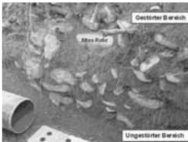
Bild 2: Die alte Abwasserleitung (altes Rohr) wurde damals in die Fundamente der äußeren Stadtmauer verlegt. Der Befund wurde dabei nicht erkannt.
