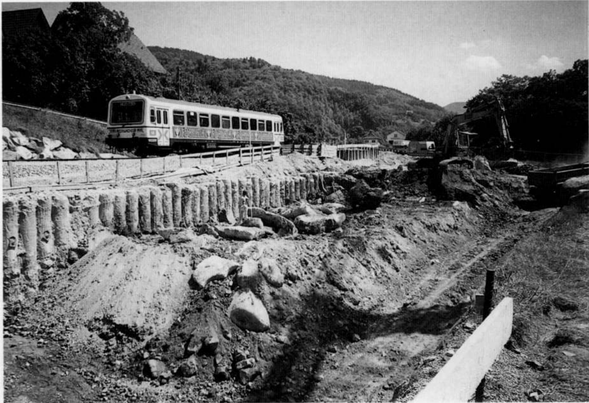
Abb. 7: Trogbauwerk Kappelrodeck-Furschenbach (Ortsumgehung Kappelrodeck) im Achertal (Nord-Schwarzwald) mit eingebrachter Betonschlitzwand der Nordseite und zahlreichen kantengerundeten Erratikas (Findlinge bis 150 t Gewicht) in einer 8 m mächtigen, im ganzen Achertal verbreiteten Grundmoräne (130–330 m NN). Untergrund: grobkörniger Achertalgranit (220 m NN).
