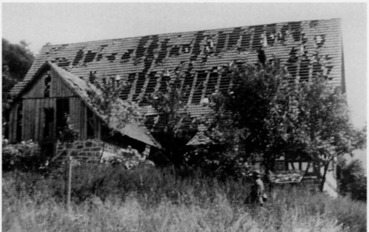
Durch die Druckwelle wurde der Bauernhof „Murhof“, der in unmittelbarer Nähe stand, schwer beschädigt. Das Dach wurde dabei weitgehend abgedeckt, Wände waren eingedrückt, Holzverschalungen abgerissen Abb.: Käshammer
