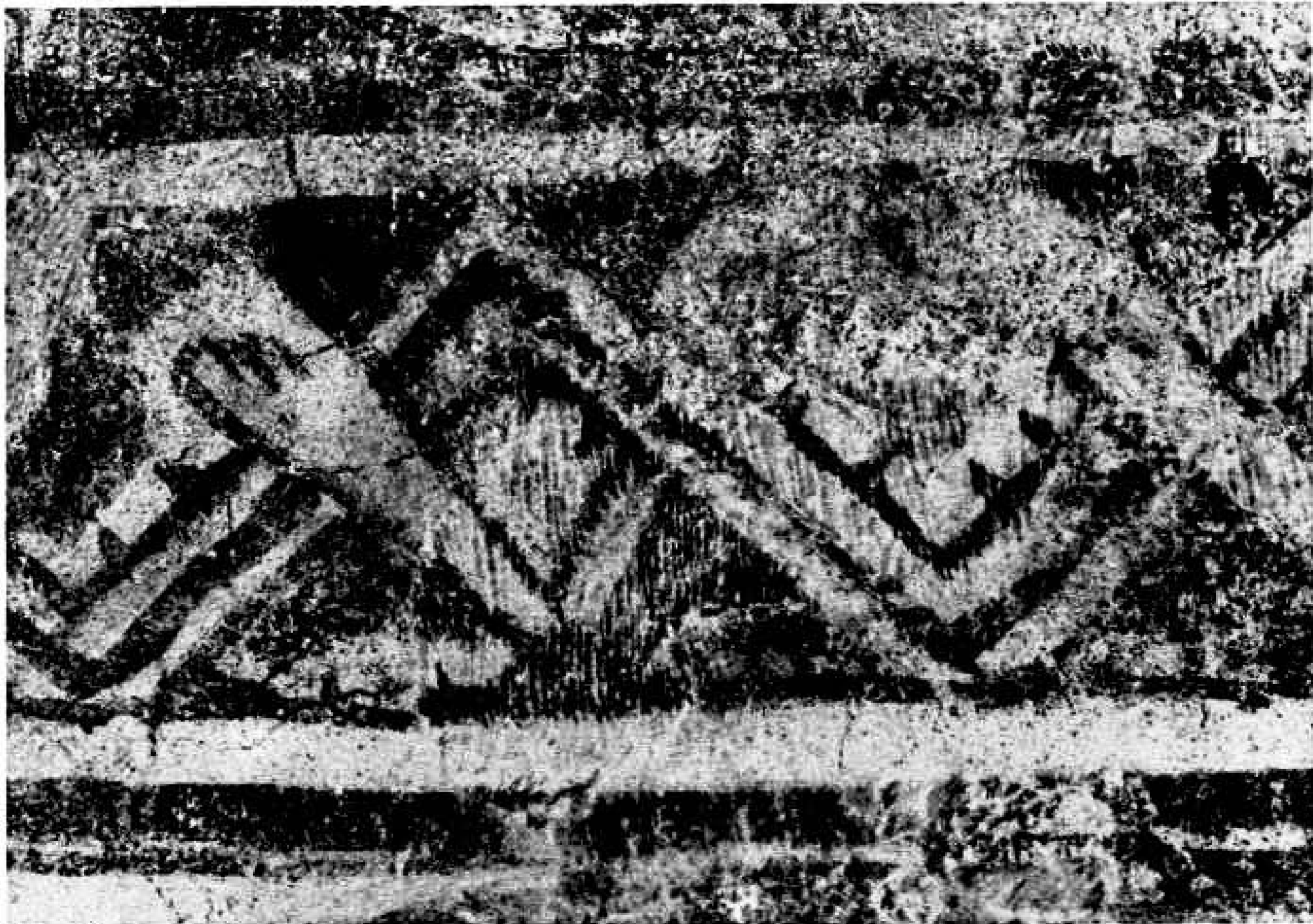
Abb. 13 Südseite, mittlerer Trennfries.
