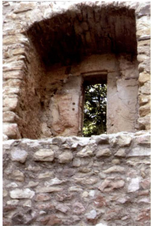
Abb. 9 Nordwestliche Ecke der Schneeburg. Fenster im 1. Obergeschoss mit Gewände und originalem Verputz (Foto: Heiko Wagner 2002).
