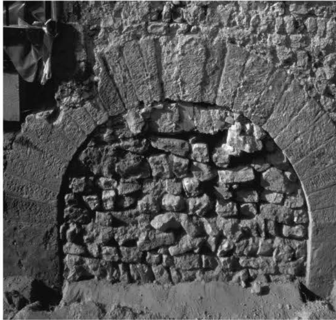
Abb. 6 Riegel, Michaelskapelle. Ansicht des vermauerten rundbogigen Portals in der Nordwand (Foto: Wagner/Jenisch).
