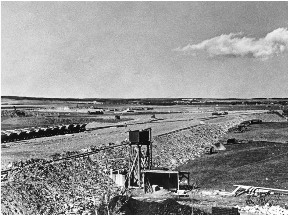
Um das Planum für das Hüttenwerk zu erstellen, waren gewaltige Geländeaufschüttungen nötig. Aufnahme vom Oktober 1940. Saarstahl AG.
