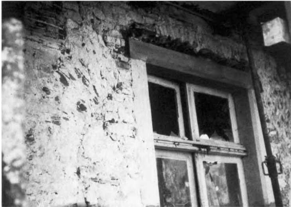
Abb. 4 Mittlere Türe des Risalits im Erdgeschoß. Bei abgeschlagenem Putz ist links neben dem Tür gewände der Bogen des ehemaligen Einganges zu sehen.
