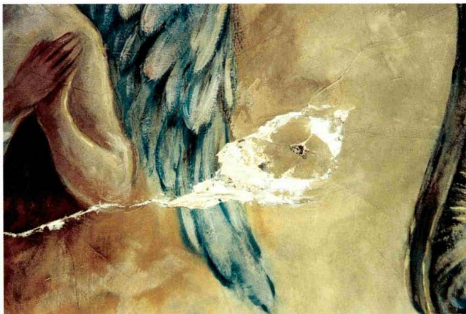
Abb. 6: Schadstelle im großen Deckengemälde
