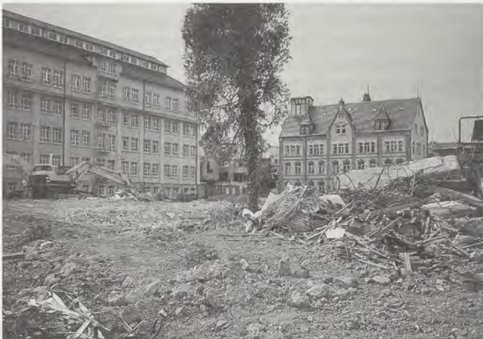
Foto 8: Mit Ausnahme der denkmalgeschützten Gebäude wurden die Fabrikationsanlagen auf dem Hohner-Karree in Trossingen abgerissen. Als Folgenutzung ist eine Überbauung mit Wohnungen und Geschäften sowie mit einem Hotel- und Gastronomiebetrieb vorgesehen. Aufnahme 1997.
