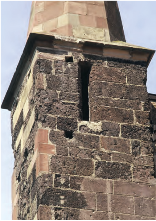
Abb. 6: Treppenturm des Breisacher Münsters mit mehr oder stark angewitterten Quadern aus Tephrit-Pyroklastit des „roten“ Typs. Foto: W. W.
