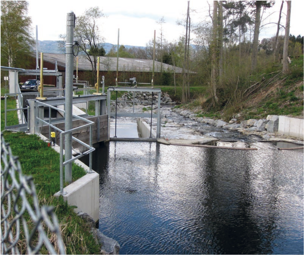
Abb. 21: Einlaufbauwerk eines Kleinkraftwerkes bei Kirchzarten. Foto: Christian Leibundgut, 2012.
