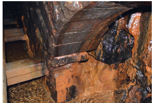
Abb. 7: Brunnenstollen Fassung: Stollenende mit dem Quellaustritt aus der Buntsandstein-Kluft rechts unten im Bild. Foto: Anton Hatt, 2014.
