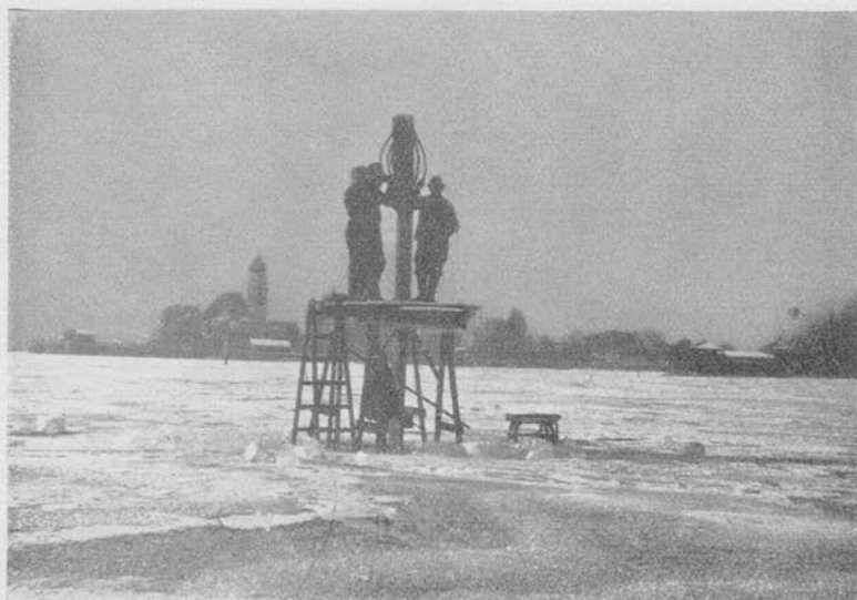
Abb. 1. Einrammen eines neuen Pfahls bei Wasserburg vom Eis aus. An den herausgehakten Blöcken ist die Eisdicke zu erkennen.
