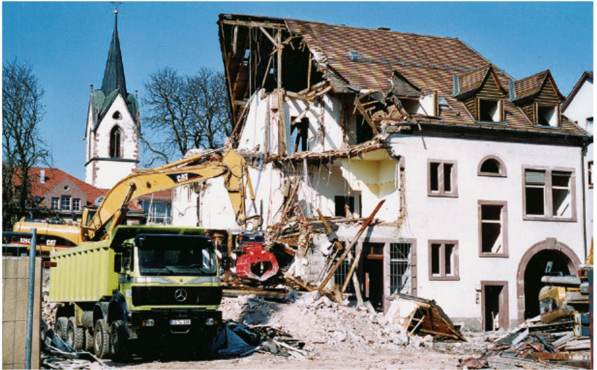
Abb. 3 Abbruch des Hauptgebäudes, April 2004, von der Brigachstraße her gesehen. (Im Hintergrund die Johanneskirche). Die Gebäude Brigachstraße 2 und 3 sind bereits niedergelegt.
