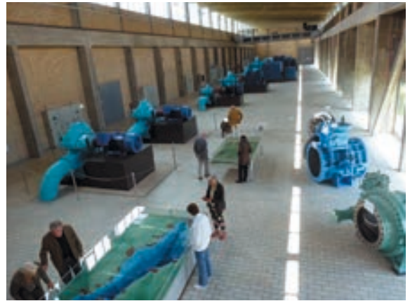
Abb. 13: Pumpwerke im Wasserversorgungswerk Sipplingen.
