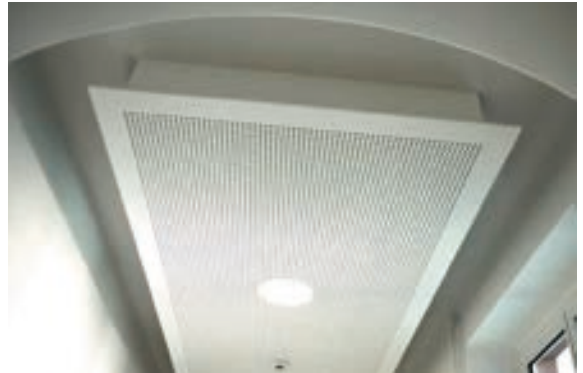
Abb. 12: Abgehängte Deckensegel im Flurbereich mit sichtbar gelassener historischer Decke mit Rundungen im Bereich des Wandübergangs zur Decke.
