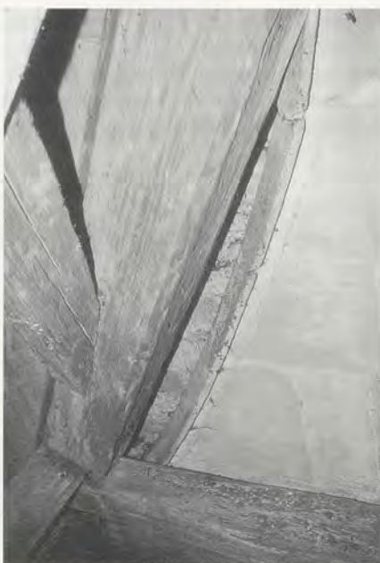
Der nordwestlichste Chorausßenpfeiler wurde anscheinend nachträglich eingemauert.
